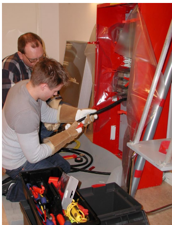
Övning i kabelskåp
