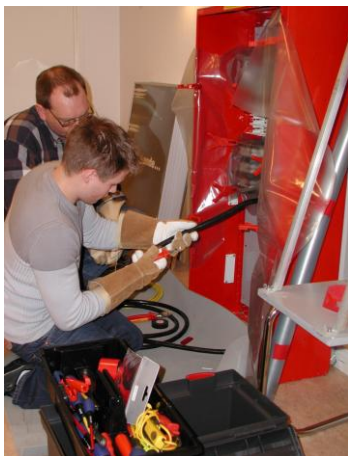
Övning i kabelskåp
